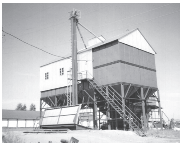
Рис. 2 – Зерноочистительный комплекс в ООО «Карсинское»
